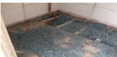
Fig 1: Loose fill asbestos fibres
